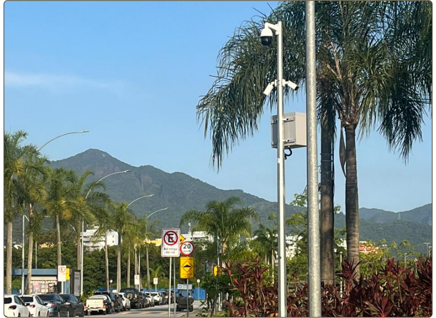
Serviço de implantação do projeto de monitoramento por câmeras.
